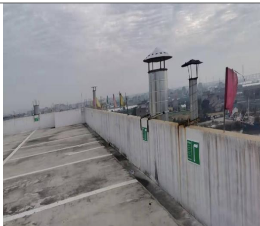
楼顶排气筒全景
