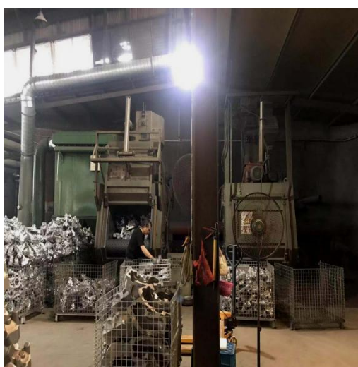
抛丸废气处理设施
