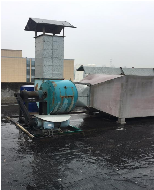
废气处理设施
