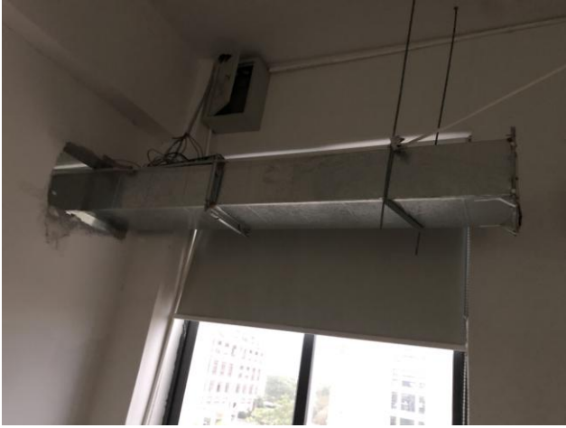
项目晾干房废气收集
