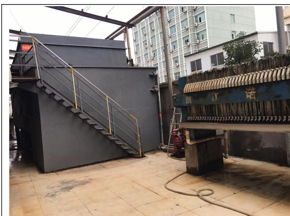
废水处理设施
