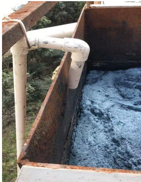
生活污水汇合到废水处理设施
