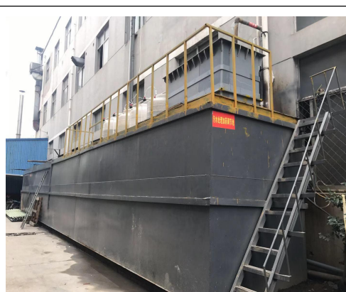
废水处理设施
