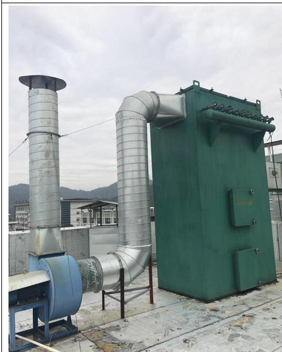
喷砂废气处理设施
