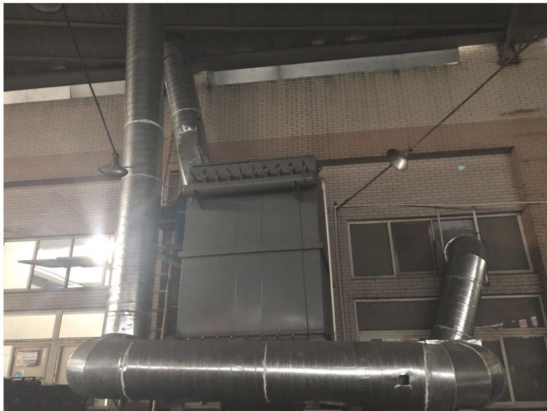
废气处理设施
